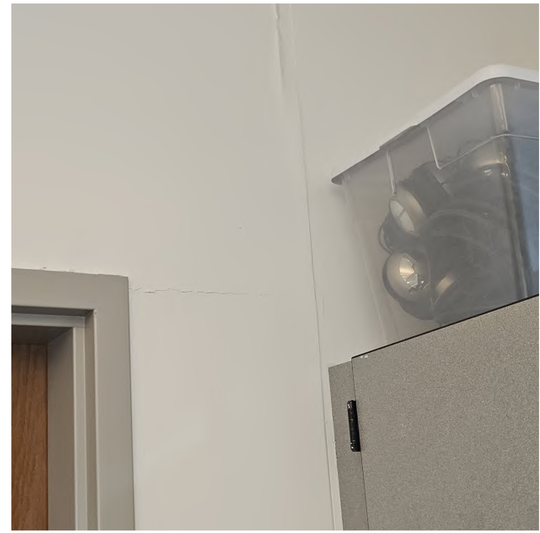
6 CRACKED DRYWALL ABOVE DOOR G120
