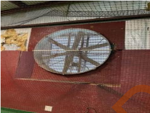
Noisy wall exhaust fan
