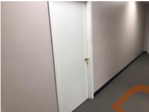
No ADA compliant door hardware
